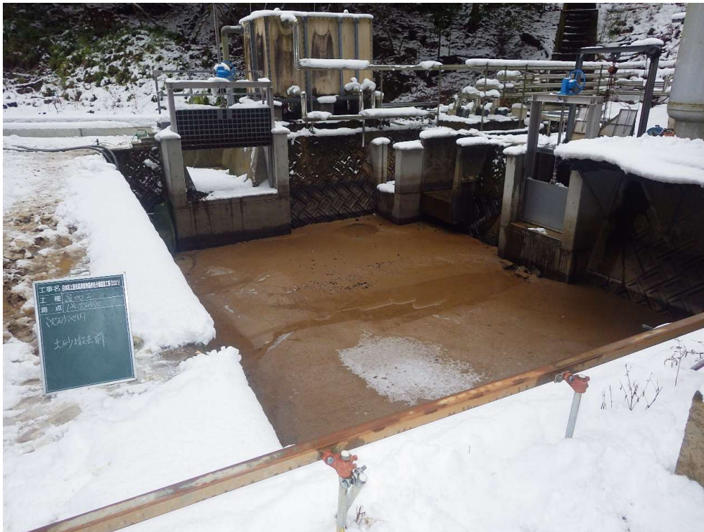
沈砂池 土砂撤去前
